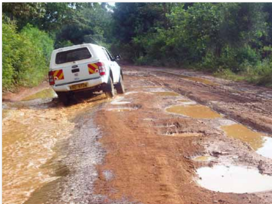
Stora hål i vägbanan på asfaltvägar, s.k. ”pot holes”, djupa fåror uppkomna efter häftig nederbörd med erosion och sliriga sandvägar är inget ovanligt.
